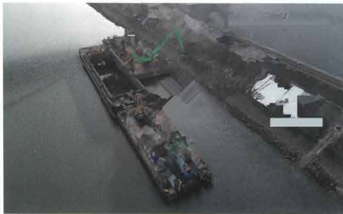
Freunde kurzer Transportwege: Der Bau einer Kaianlage soll die Direktverfrachtung per Binnenschiff ermöglichen.
